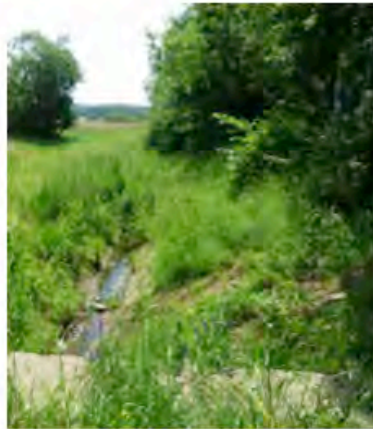
Trasse entlang des Naturschutzgebietes an der BAB 45 ca. 8 Monate nach Verlegung Juni 2010 Foto: ovag Netz AG
